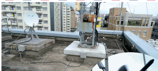
▲機械室上部にしっかり固定されているクランクアップタワー
